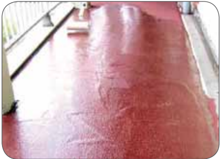
Fig. 20 Rilvorming door onvoldoende verdelen van de 1ste laag Nylo Decofloor GT
