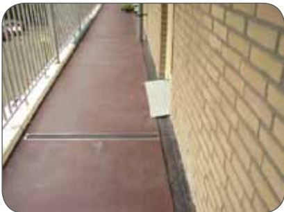
Fig. 15 Galerijvloer 1 jaar na oplevering.
