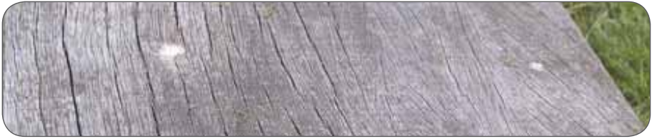
Fig. 3: Scheurvorming in verweerd bangkirai
